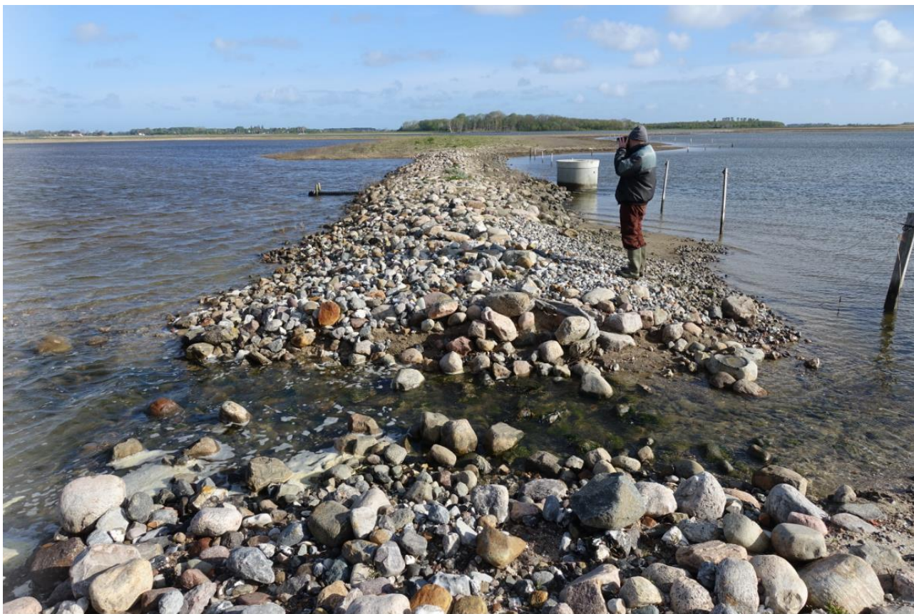
Diget der skal holde vandet ude af det nye SV-område er nu desværre gennemroderet, således at Odense Fjord oversvømmer området. Foto: Kurt Due Johansen.
